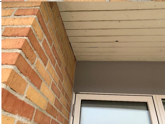
B1 mod syd. Underbrædder ved altan.
